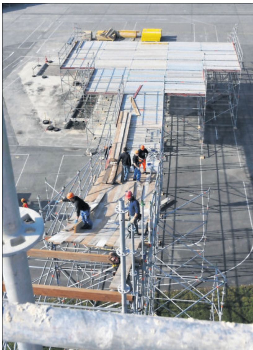
Hier liegt am Samstag Schnee: Die 18 Meter hohe Rampe ist gegenwärtig im Bau.
